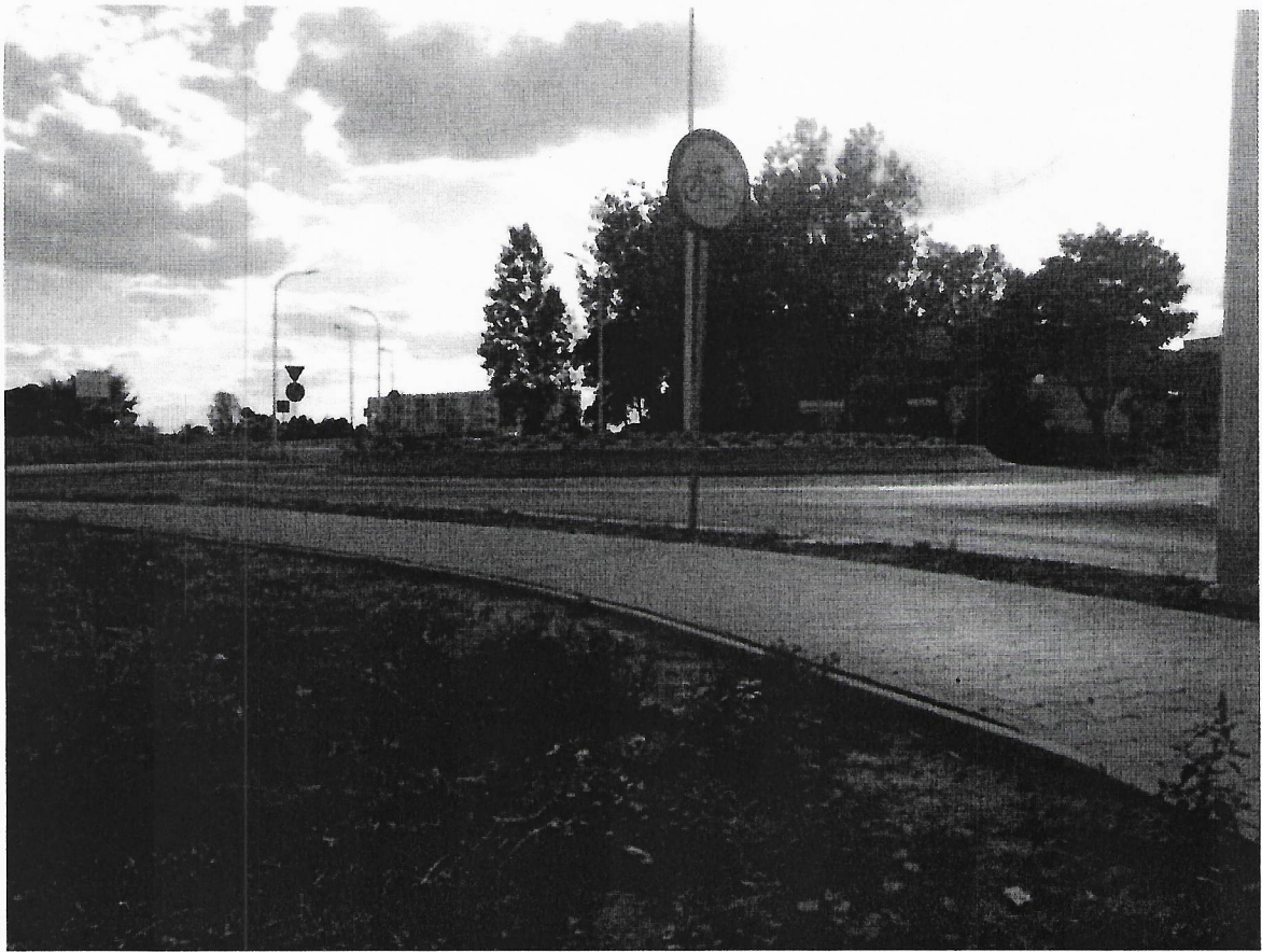
Rondo im. Pułkownika Antoniego Mosiewicza bez barierek, tańcuchów zabezpieczających jezdnię od chodnika.
